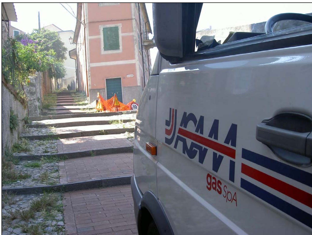
furgone dell'ACAM di La Spezia sulla via Casini a Pugliola, durante i lavori oggetto del presente articolo
