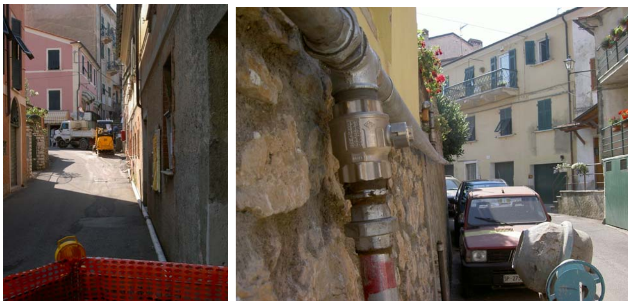
due particolari del by-pass in acciaio realizzato preventivamente alle opere di relining
