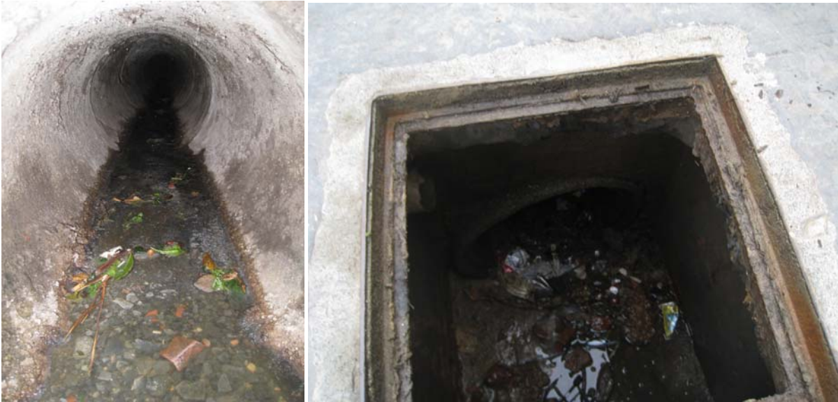
Due immagini dell'interno della condotta e del pozzetto di recapito prima dell'intervento di relining
