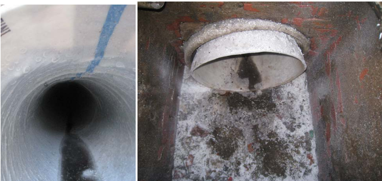
Il nuovo aspetto interno della condotta e del pozzetto di recapito dopo l'intervento di risanamento.
