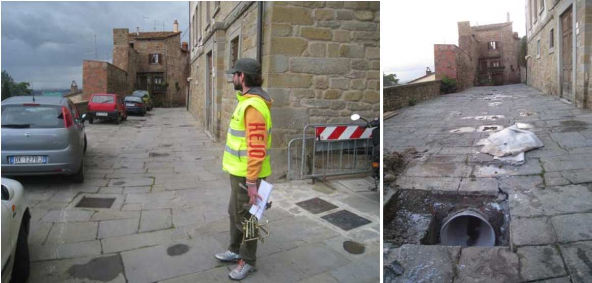
Due vedute dell'area del cantiere prima e dopo l'intervento: si noti il davvero minimo ricorso alle opere di scavo
