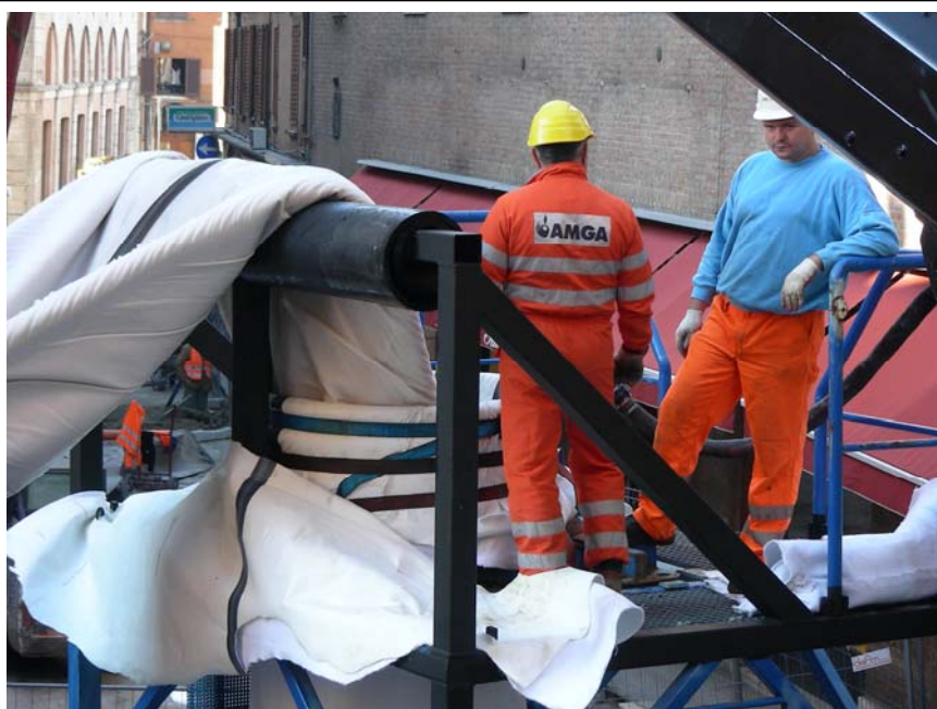
inversione ad acqua di tubolare di grandi dimensioni (1400 x 1000 mm) effettuato in centro storico cittadino
