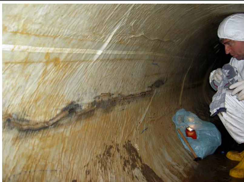
Frattura longitudinale verificatasi su condotta in pressione risanata con tubolare non idoneo
