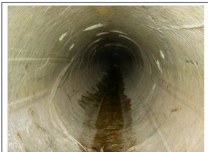
Esiti di iniezioni di resina successivi alla applicazione CIPP resisi necessari a seguito di mancata adesione del tubolare alle pareti interne della condotta ospitante
