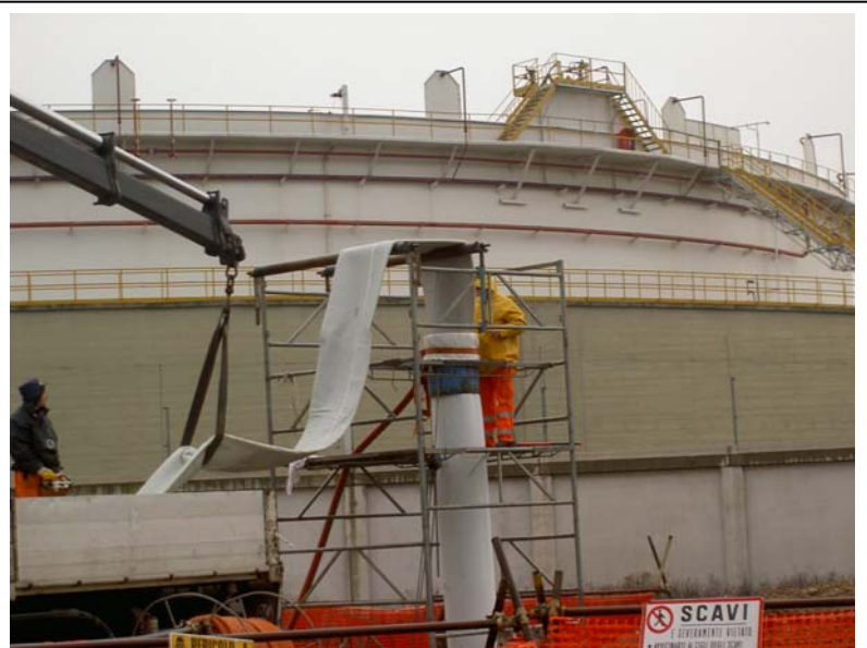
inversione ad acqua effettuata in ambiente industriale
