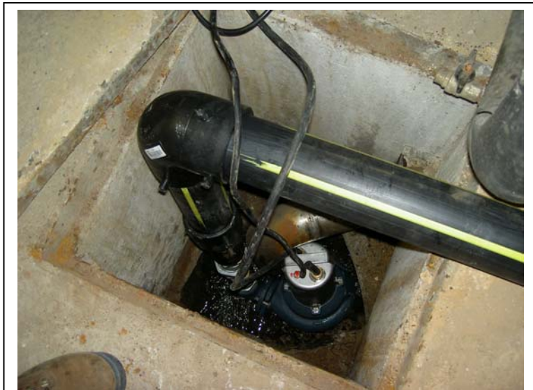
piccolo pozzetto di intercettazione di fognolo di immissione
