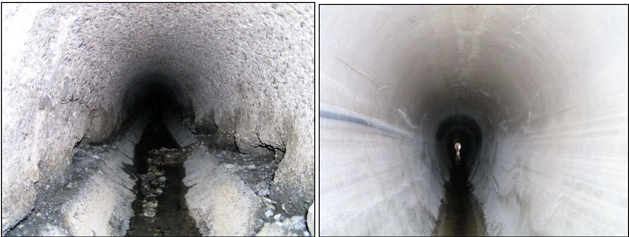
una condotta fognaria che mostra tutti i segni del tempo e dall'esercizio prima e dopo l'applicazione di una guaina CIPP
