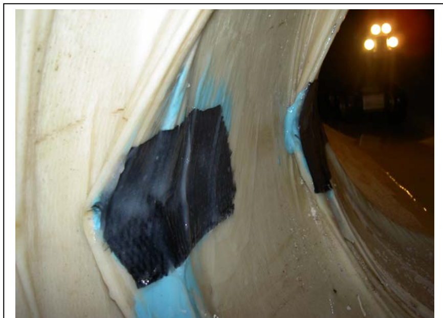
“pezze” su grinze fratturate verificatesi a seguito di non corretta procedura di posa in opera
