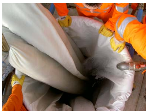
fasi di discesa della guaina verso il pozzetto di inserzione e di richiamo della guaina sotto colonna d'acqua
