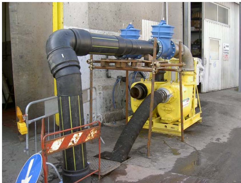
doppia installazione di pompe elettriche della portata di 400 mc/h cadauna messe in parallelo in modo da poter avere la certezza della non interrompibilità del by-pass anche in caso di guasto
