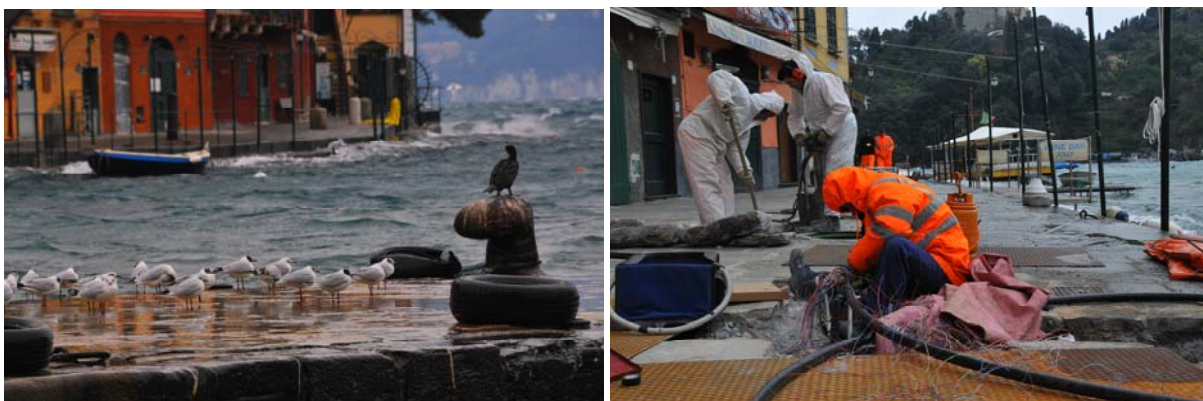
Scenari poco noti o inconsueti per Portofino: mare in tempesta e scavi a cielo aperto a pochi metri dalla celebre Piazzetta, che fanno da corollario al primo intervento che descriviamo
