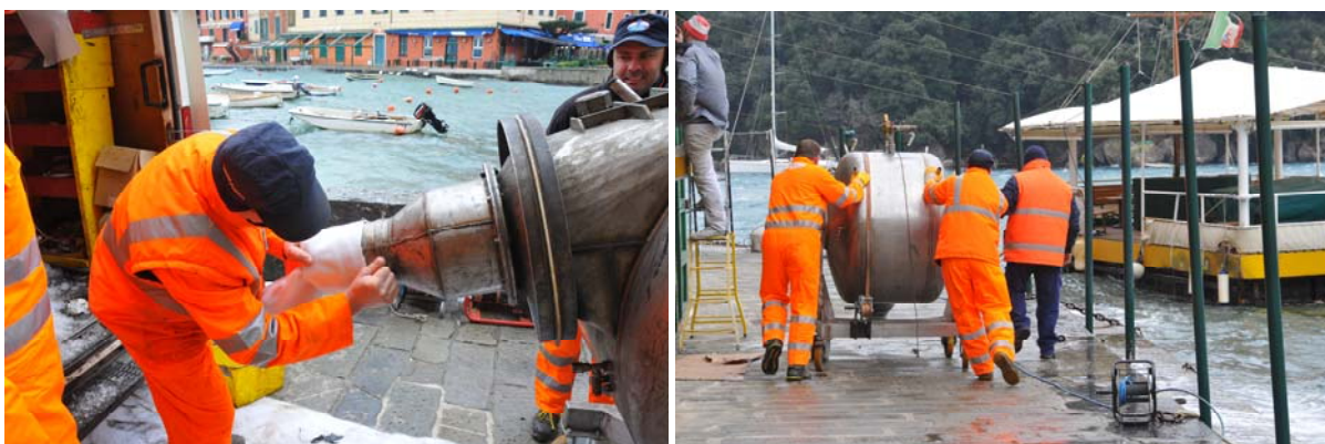
Due fasi della lavorazione: preparazione della guaina CIPP pronta all'inserimento e il difficoltoso spostamento dell'estroffessore verso l'estremità a mare della calata Marconi
