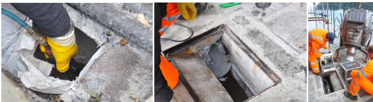
Tre fasi conclusive: taglio dei terminali, rifinitura delle immissioni nei pozzetti e ispezione finale di collaudo della condotta risanata
