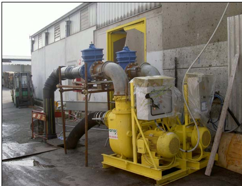
il doppio sistema principale di aspirazione per sopperire all'eventuale avaria di una pompa
