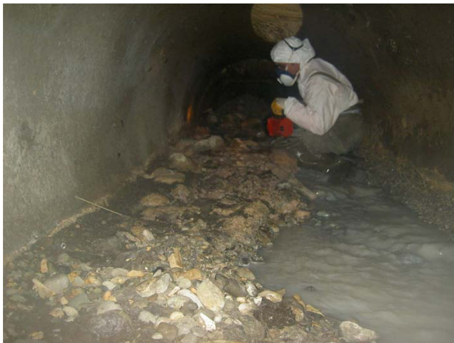
una volta asportati i residui di lavorazione del latte, aspirati dal by-pass, la presenza di sedimenti solidi quali ciottoli e ghiaie fa presumere un danno a monte
