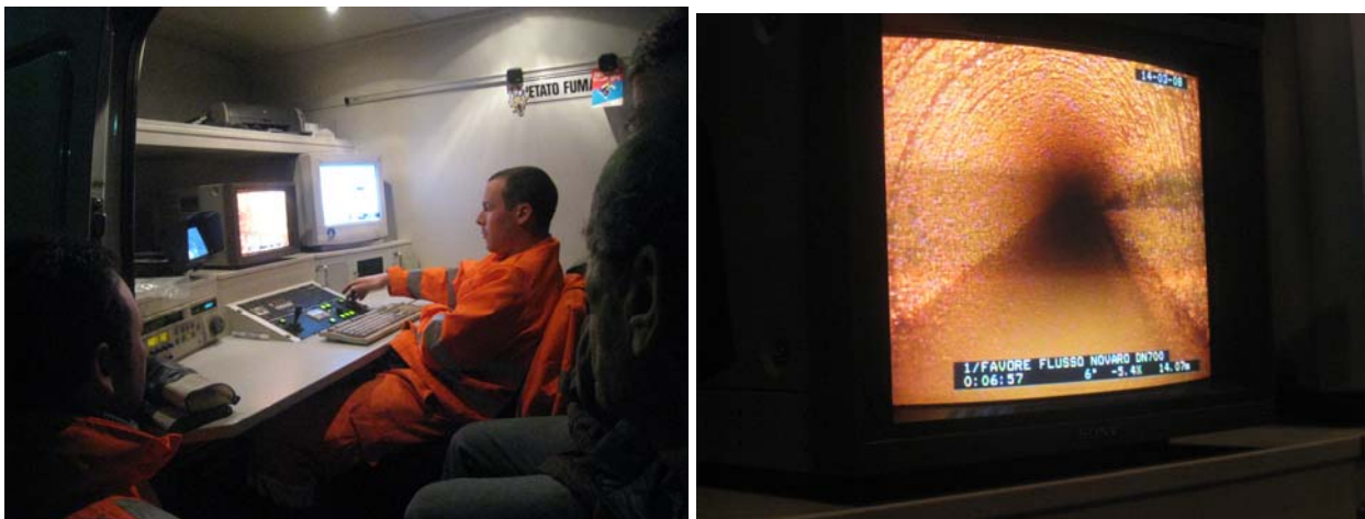
La centrale di controllo della attrezzatura di videoispezione e una veduta dell'interno della condotta in una zona di contropendenza
