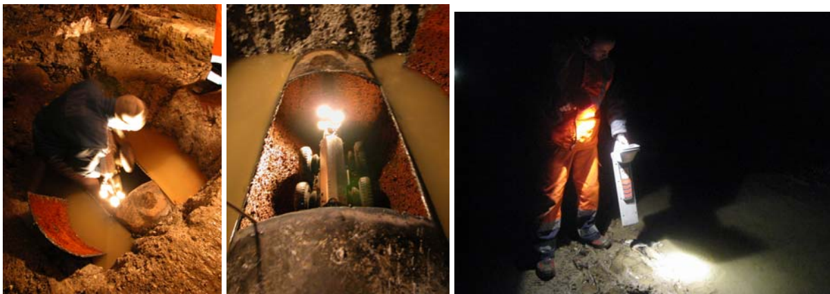
Tre fasi dell'ispezione televisiva: l'inserimento del trattore, la partenza (si noti lo stato delle concrezioni ferrobatteriche all'interno della condotta) e il rilevamento del tracciato della tubazione
