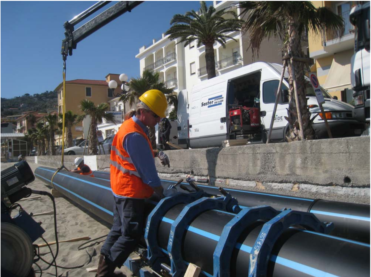
La fase di avvio delle operazioni di saldatura del liner in PE100, DE500 PN16
