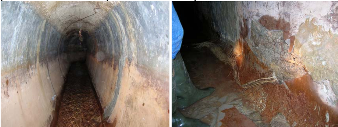
Due immagini che testimoniano le condizioni interne del canale prima dell'intervento
