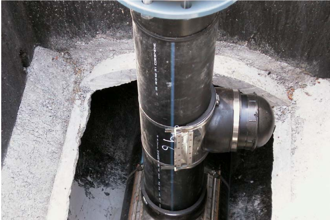
foto 7, particolari delle derivazioni orizzontali da stacco verticale in PEAD
