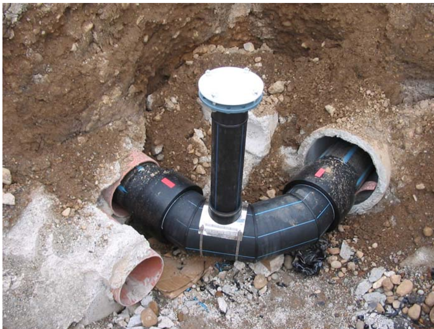
foto 8, particolari relativi alla realizzazione di uno stacco verticale in corrispondenza di una curva a 90° sulla condotta
