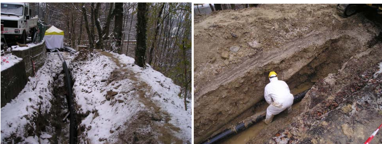
Due immagini che testimoniano la difficile situazione meteorologica ed ambientale che si sono verificate nel corso dei lavori
